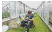
ハウスの破損ガラス清掃 (寺尾さとし氏提供)
