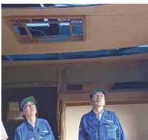
強風で屋根が飛ばされた家屋を調査する加藤県議(右)とみわ県議(左)
