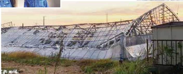
強風で押しつぶされたハウス
